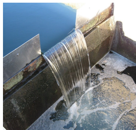
La Planta de Tratamiento de Aguas Residuales toma las aguas residuales sucias y las convierte en agua limpia y cristalina antes de devolverlas al río Eno.
